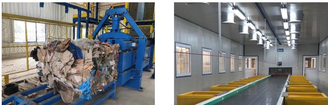
Figura 4-13 Stația de sortare Molovăț
