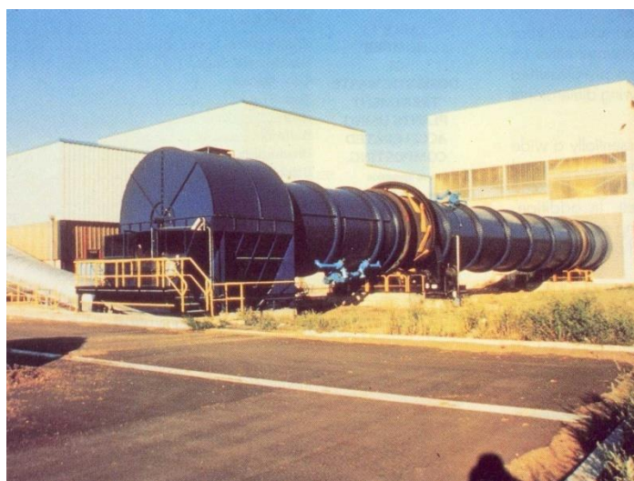
Figura 7-16 Instalație de compostare dinamică cu tambur de alterare
