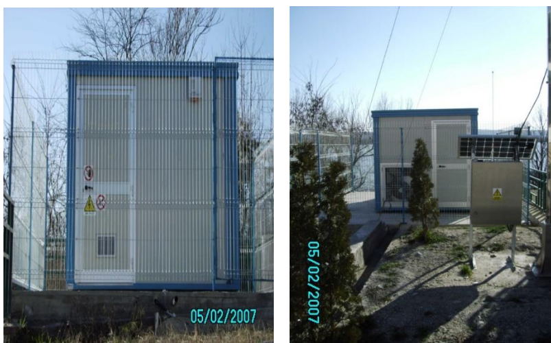
Figura nr. I.1.1.1 - Stația fixă automată MH1
